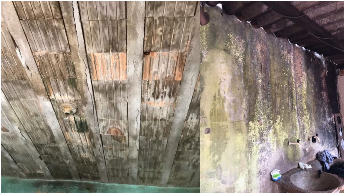
FIGURA 39 e 40 - Residência com infiltrações na laje e parede.
