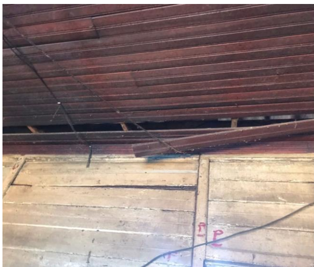
FIGURA 52 - Cobertura inadequada (Eng Correia). Burnier).
