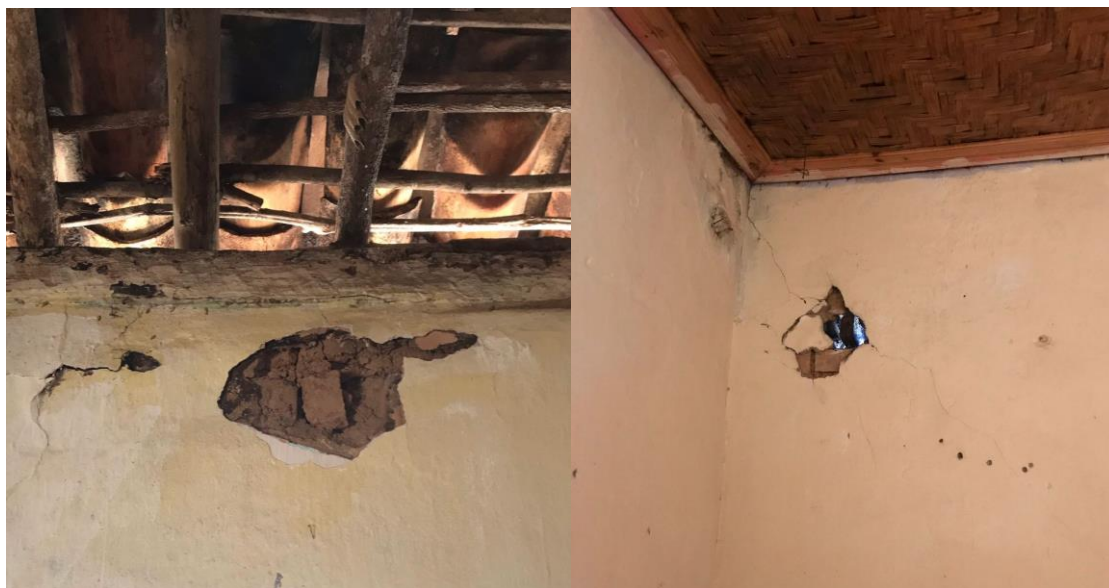
FIGURAS 20 e 21 - Paredes com precariedades.
