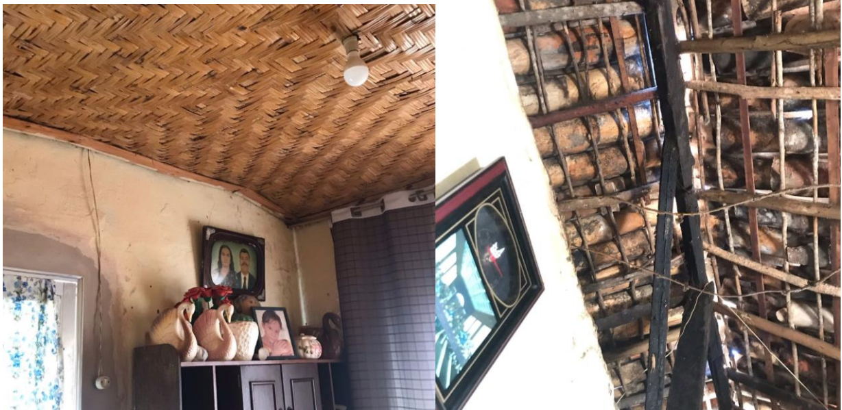
FIGURAS 16 e 17 - Forro e telhado caindo.
