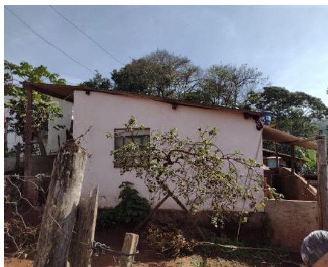
FIGURA 55 - Ventilação/iluminação inadequada (MB).
