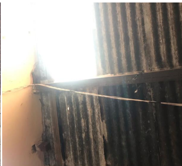
FIGURA 53 - Cobertura inadequada (M.
