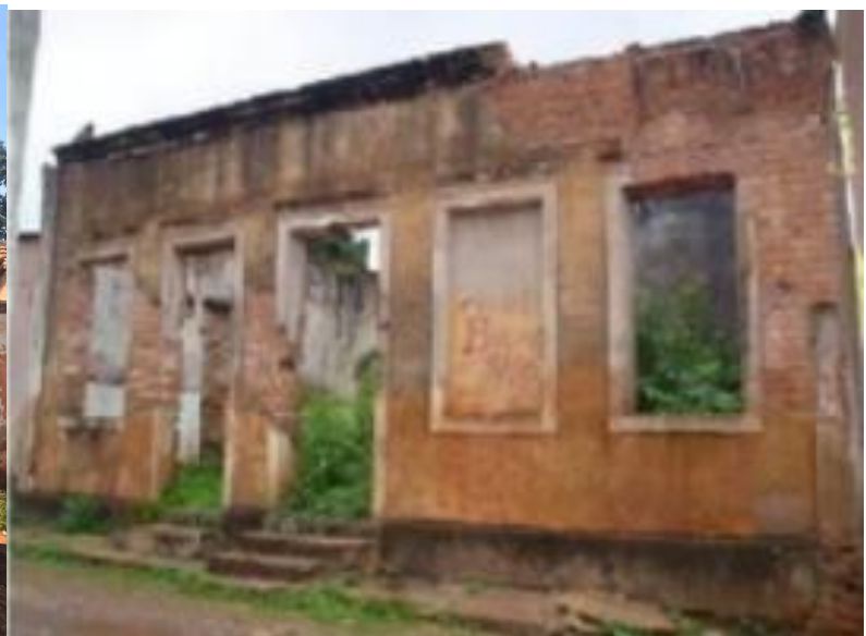
FIGURA 33 – Fachada frontal da ruína do hotel.
