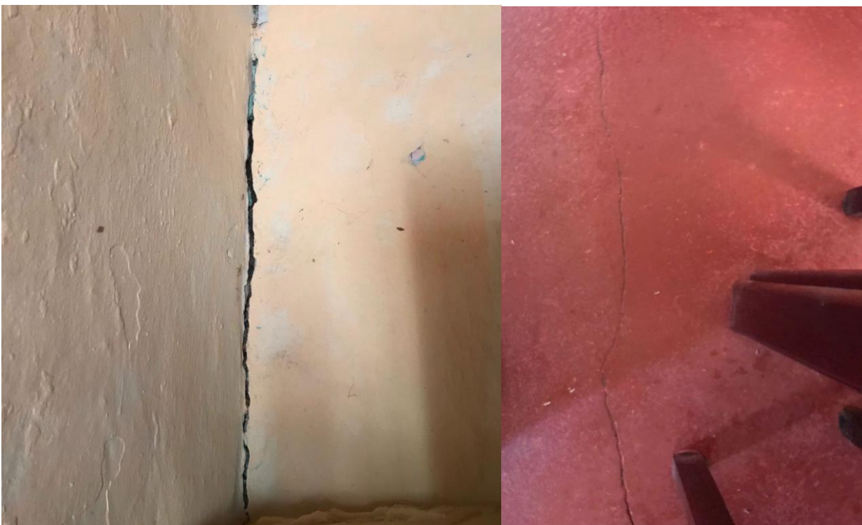
FIGURAS 18 e 19 - Rachaduras na parede e piso.
