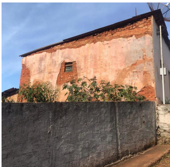
FIGURA 54 - Revestimento inadequado (MB).
